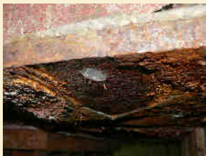
Koroze hlavního nosníku pod mostním závěrem
