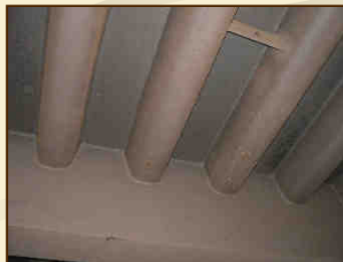
Patina na ortotropní mostovce
