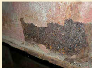
Koroze hlavního nosníku pod mostním závěrem
