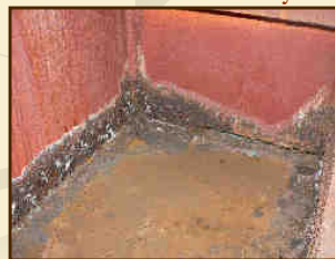
Koroze uvnitř komory
