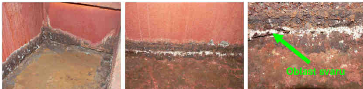
Obr.3 Koroze vnitřních natřených částí komorového průřezu mostu
