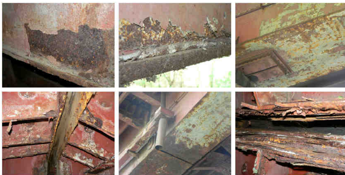
Obr.4 Poruchy nátěrového systému a koroze pod netěsnými mostními závěry a dilatacemi na silničních mostech přes řeku Odru v Ostravě
