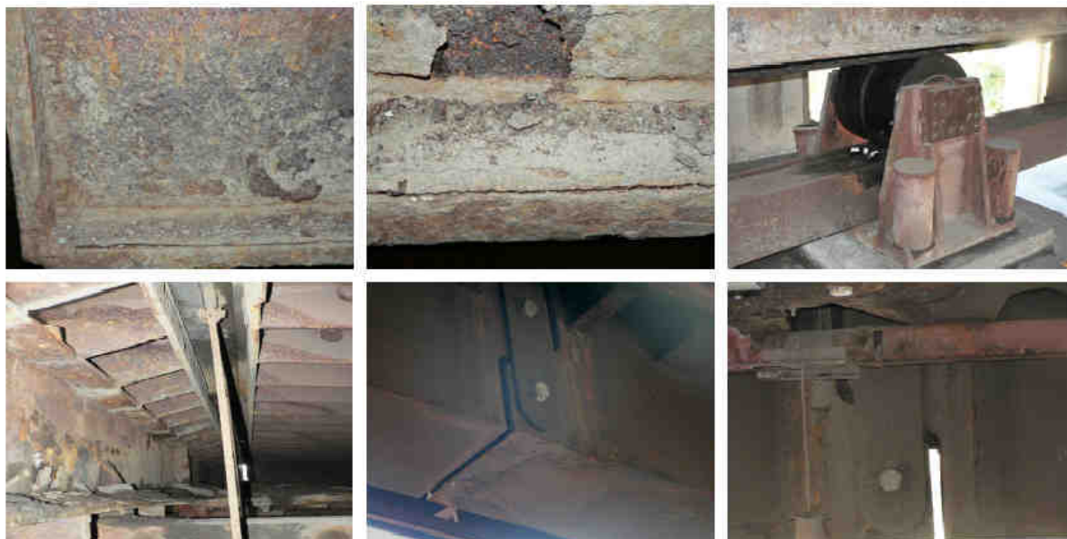
Obr.2 Nepříznivý vývoj patiny pod netěsnými mostními závěry a dilatacemi na silničních mostech přes trať ČD v Ostravě - Svinově
